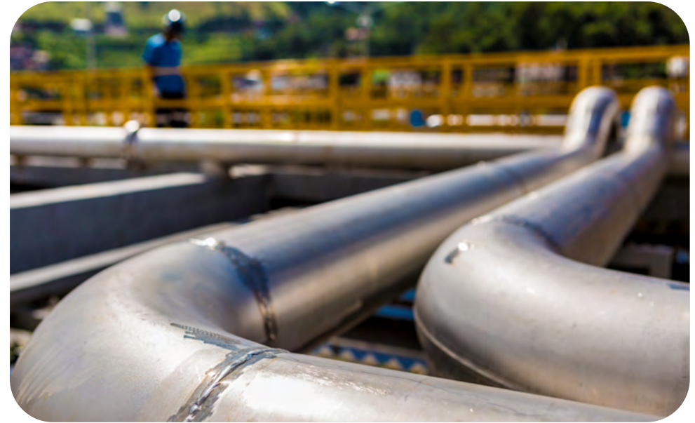
WWTP Conselheiro Paulino
